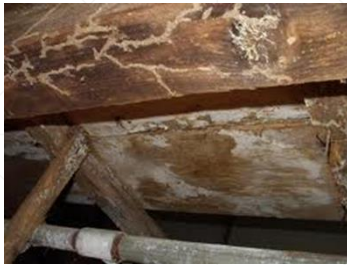
木材腐朽菌 (ふきゅうきん) 劣化原因No.1
